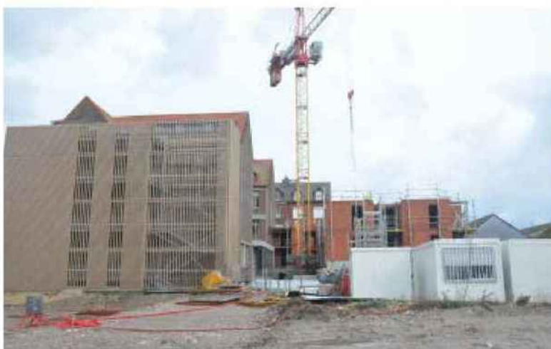
Deux immeubles collectifs sont en cours de construction face à l'hôpital (Photo Paris-Normandie)
